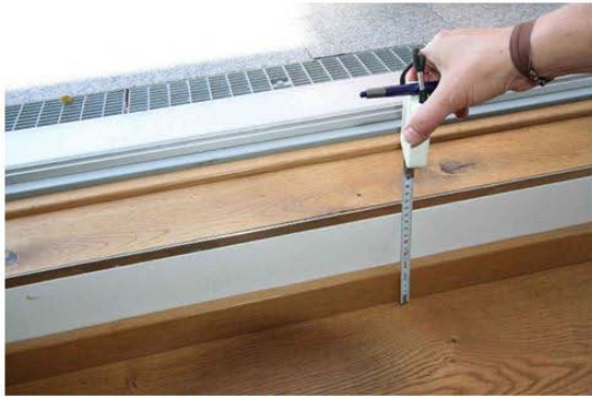
Schwelle Schiebetür Wohnzimmer/südliche Terrasse
