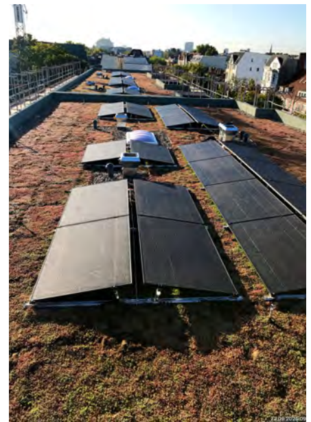
Dachbegrünung und PV-Anlage.
